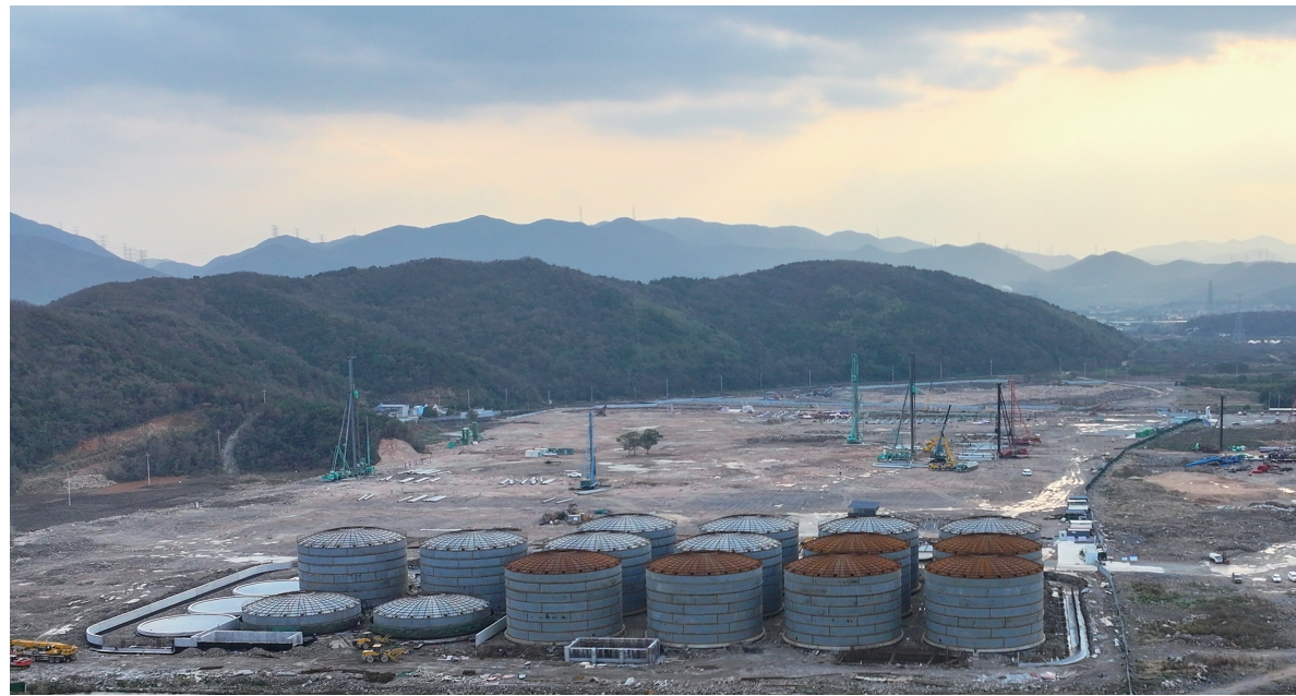
浙江聚泰新材料20万吨/年新动力电池正极原材料生产线建设项目
